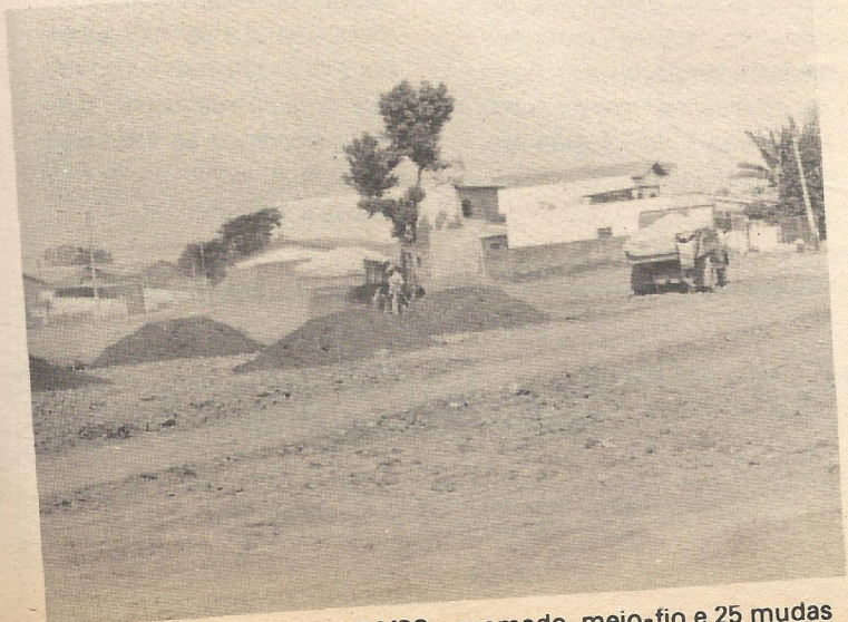
Urbanização da Entrequadra 28/30 – gramado, passeio em concreto, meios-fios e plantio de 65 mudas de árvores.
