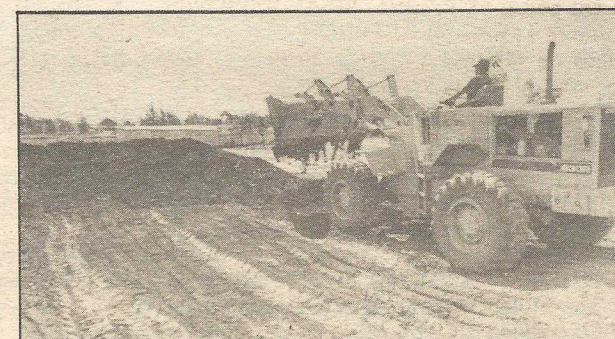
As obras do metrô chegam à cidade. As escavações começam na QE 24, e vão desviar parte da via que separa o Guará I do Guará II. A previsão é que até o segundo semestre o trecho do Guará esteja concluído.
