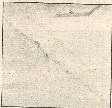
As rachaduras são visíveis e amedrontam os moradores
