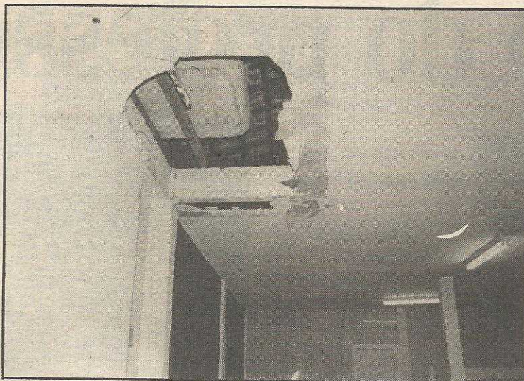
O prédio está em precárias condições
