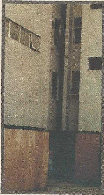
O prédio foi interditado em 93, por causa das rachaduras
