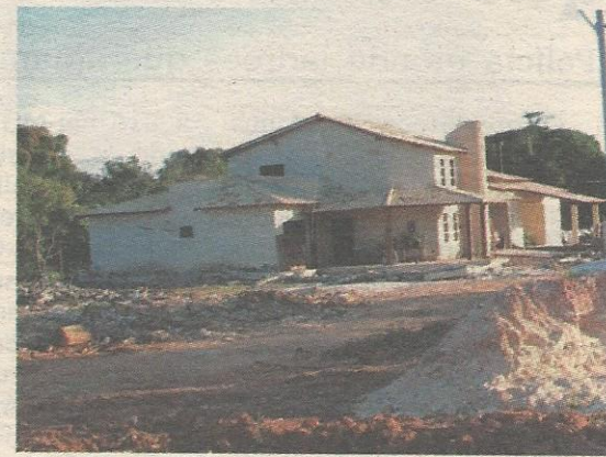
Esta casa de 500 metros terá que ser demolida
