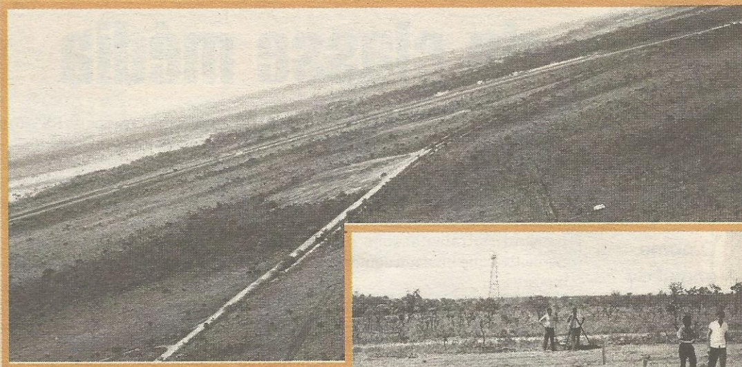
Acima, máquinas abrem a primeira rua do mutirão, vendo-se a EPTG ao lado
