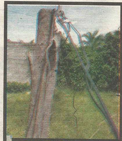
As gambiarras colocam em risco os próprios invasores
