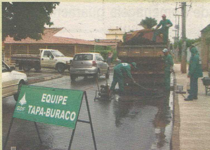
Quando as chuvas dão folga, equipes vão para as ruas recuperar o asfalto
