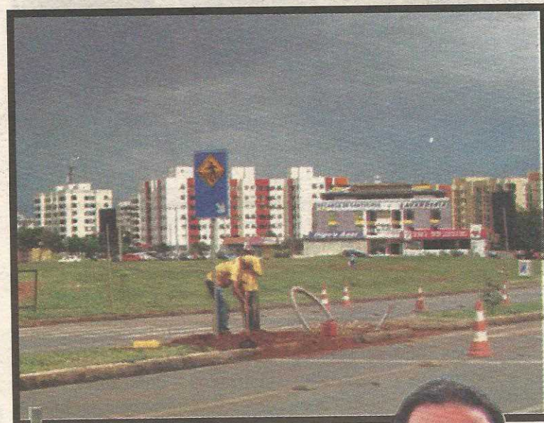
Serviço recupera todas as identificações de trânsito
