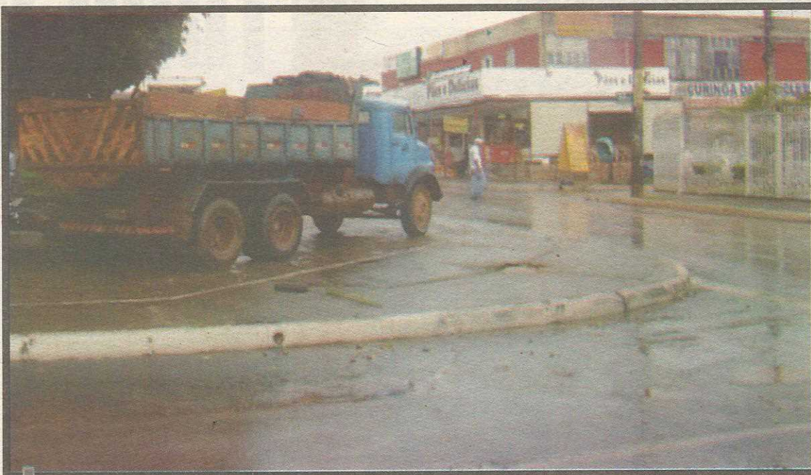
Asfalto da quadra já estava bastante danificado. Outras quadras também serão beneficiadas
