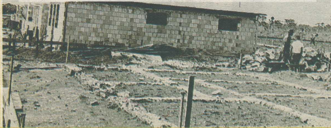
Na foto acima, topgrafos fazem as primeiras demarcaes. E as primeiras casas em construo na QE 5
