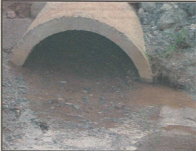
Passagem está obstruída por terra e água
