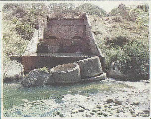
Esgoto despejado pela Caesb
