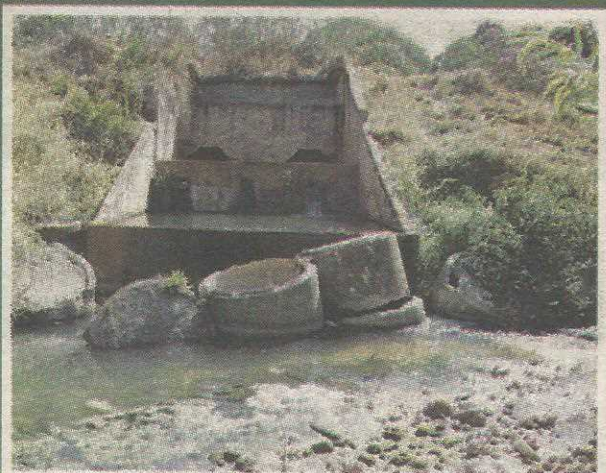
Esgoto despejado pela Caesb
