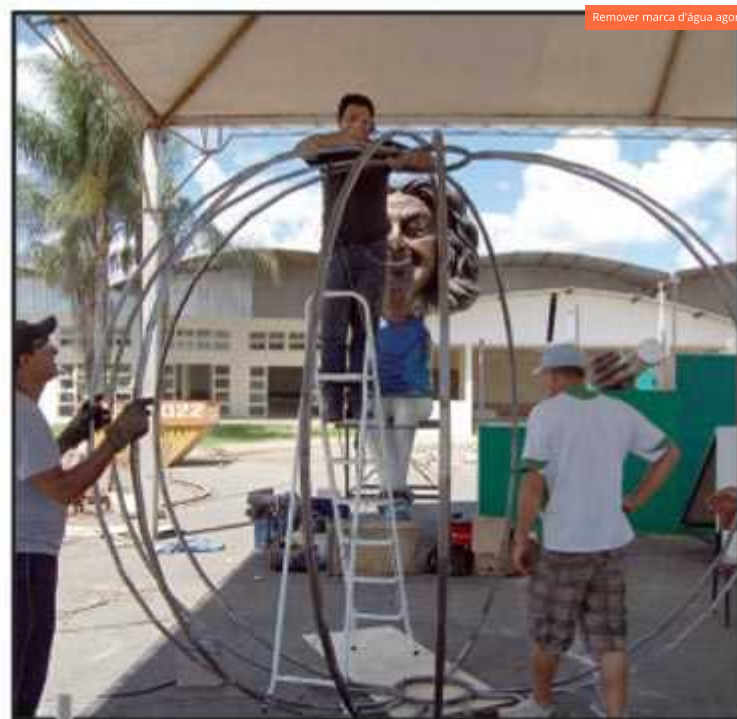
Trabalhadores correm para concluir o restante da armação para sustentar os ornamentos
