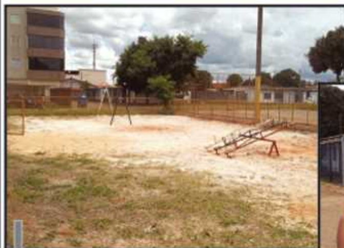
Quadra poliesportiva e parque infantil sem condições de uso
