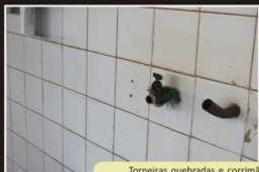
Torneiras quebradas e corrimão empenado colocam os usuários em risco
