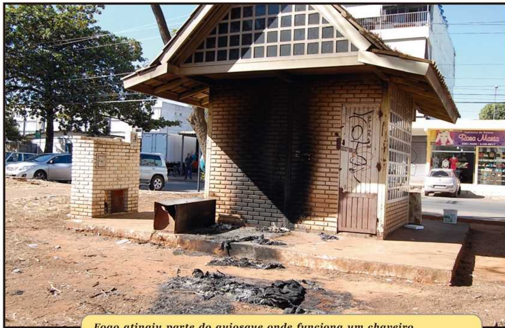
Fogo atingiu parte do quiosque onde funciona um chaveiro
