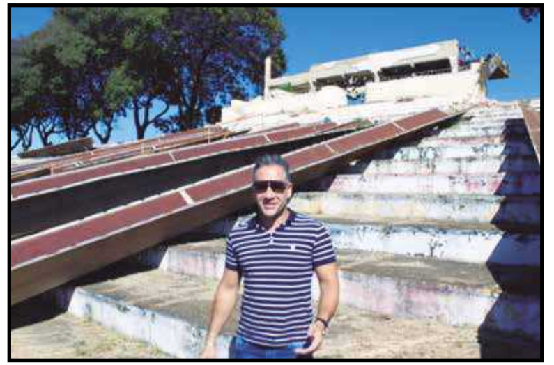
Empreiteiro Clayton Sperândio abandonou a obra alegando atraso nos pagamentos e erro no projeto técnico
