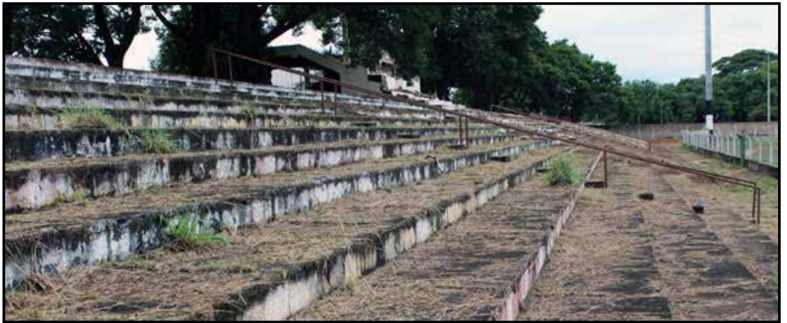
O estádio foi demolido para uma reforma antevendo os Jogos Olímpicos do Rio de Janeiro. A obra nunca avançou
