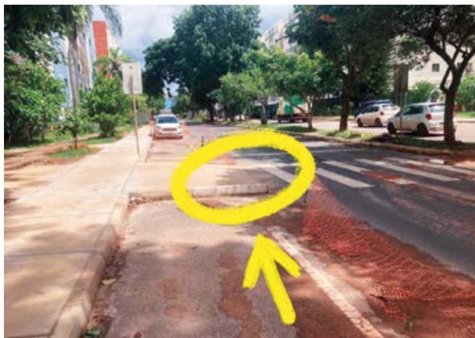
A instalação de barreiras para a passagem de pedestres tem provocado estragos de pneus a motoristas desavidos
