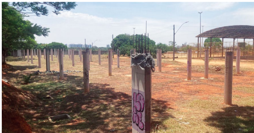
A empreiteira que ganhou a licitação construiu as bases dos vestiários, mas o serviço foi abandonado no início da reforma
