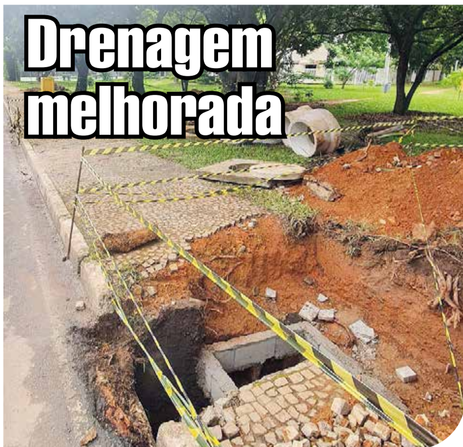
Reconstrução de poços de visita facilita manutenção da drenagem. Ação da Novacap na troca da laje da estrutura de acesso à rede para facilitar manutenção e desobstrução das galerias
