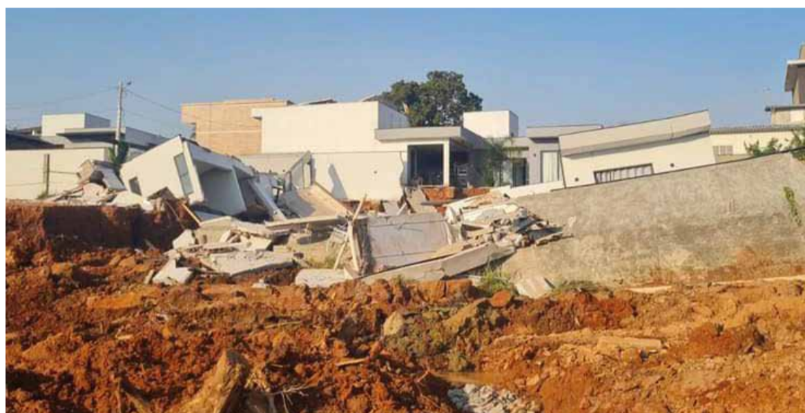
Casa ficou inteiramente destruída. Outras duas residências podem ser afetadas pelo deslizamento de terra no mesmo condomínio
