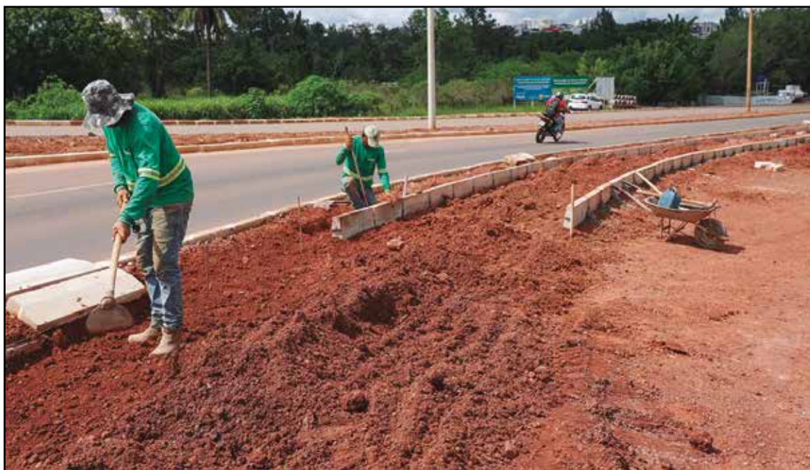
As calçadas seguem as normas técnicas de acessibilidade, com largura mínima de dois metros e superfície regular
