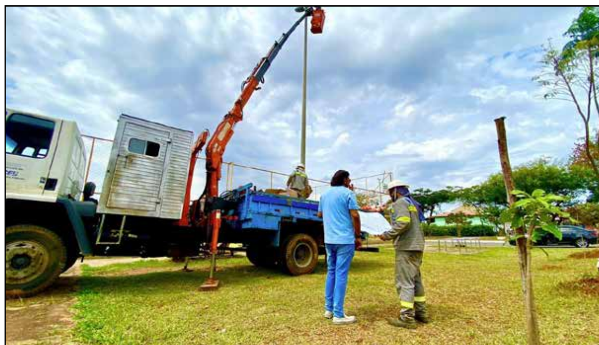
Desde janeiro de 2023, a iluminação em LED no Guará saltou de 14% para quase 80%. Mas o furto de cabos compromete essa percepção. Com a nova lei, a expectativa é recuperar a sensação de segurança nas ruas.
