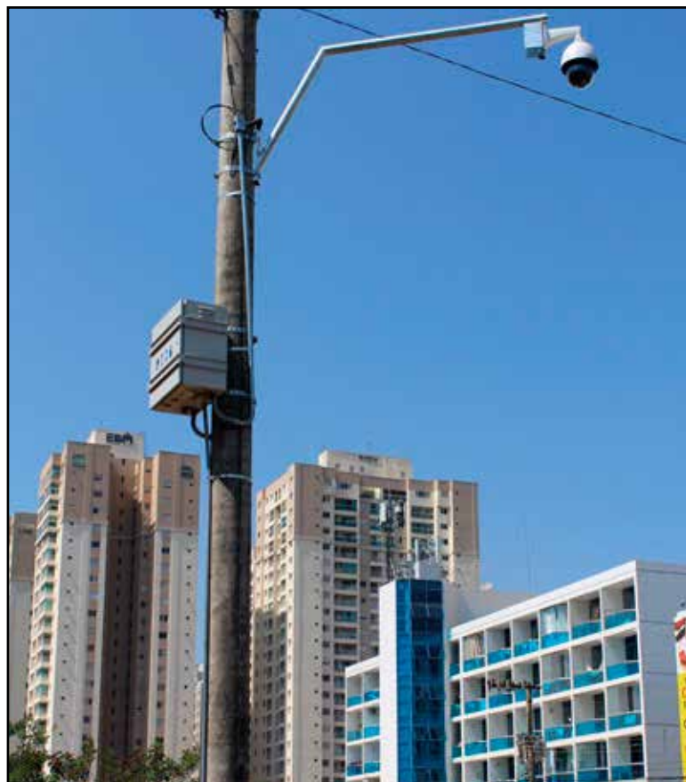
Câmeras de monitoramento instaladas no Guará serão integradas ao sistema DF 360, ampliando o acompanhamento em tempo real e o apoio às forças de segurança.
