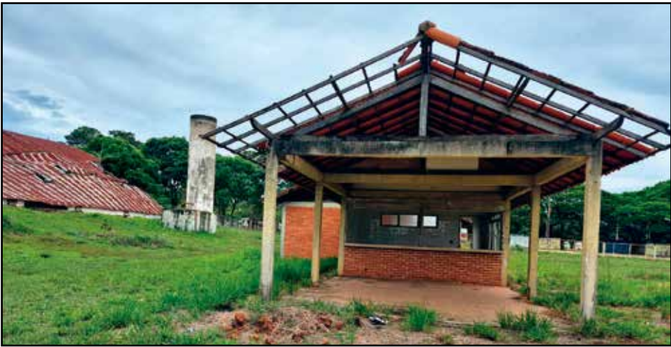
O estádio, o ginásio coberto, as quadras poliesportivas estão em ruínas, sem condições de uso
